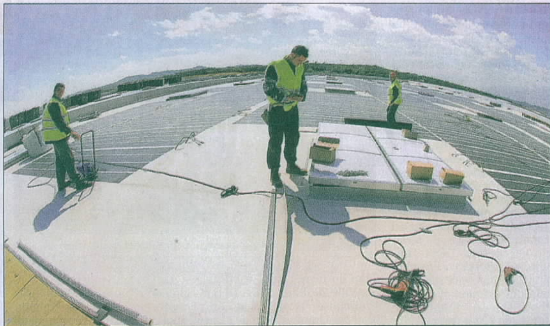
30 000 m 2 de capteurs solaires sur la plate-forme de FM Logistic, soit la surface de 10 terrains de football.
