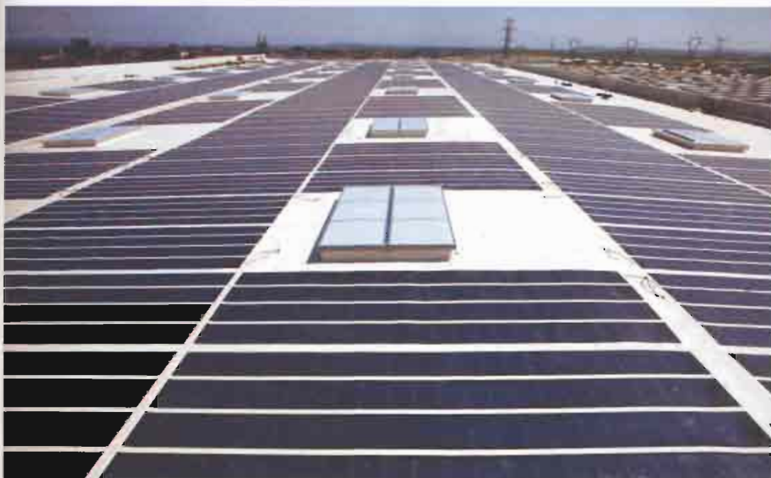
Cette centrale en toiture produira 1,65 million de kWh, soit la consommation électrique moyenne de 500 ménages.
